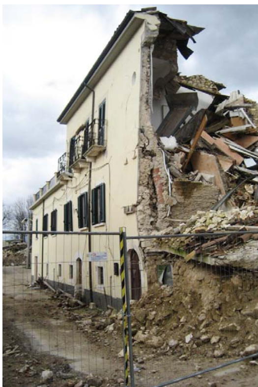
Bed & Breakfast "Le Rondini" in via del Forno a Onna, costruito su locali con volte a botte, conserva anche un pozzo profondo 30 m che attraversa strati argillosi fino alla falda sottostante. Nella pagina accanto, la piazza con la Chiesa di S. Pietro Apostolo nel cuore di Onna, prima del tragico evento.
